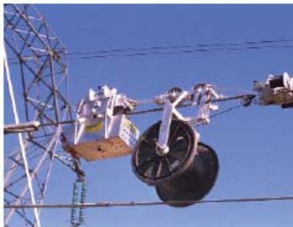
ОРАС, проводник надземног вода и привезна трака
