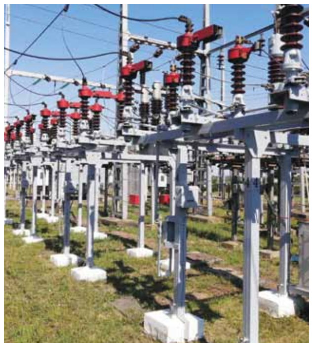
Ревизија ЕЕО 110 kV на територији ЕД Смедереву
