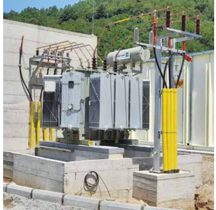
Лесковац: Новом ТС 35/10 kV „Горњи орах“ потрошачи добијају стабилнију и сигурнију снабдевању
