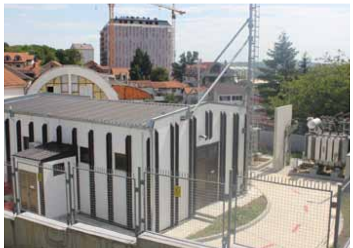
Реконструисана трафостаница 35/10 kV „Смедеревски пут“
