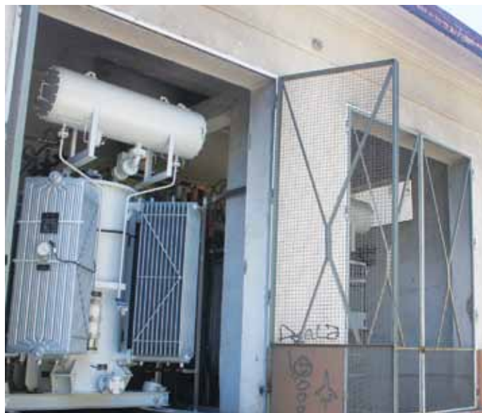
ТС Доварје - трансформатор у боксу
