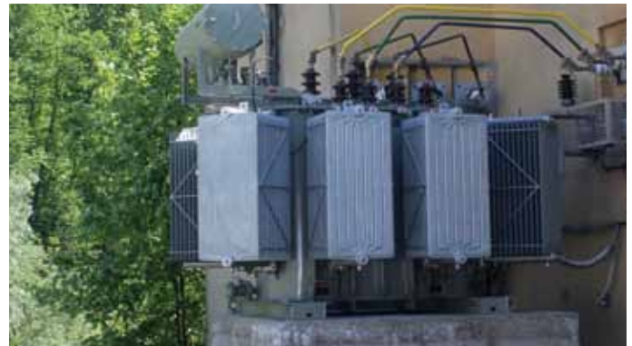
Реконструисана ТС 35/10 kV Буковица: Урађен нов трансформатор од 4 MVA инсталисане снаге
