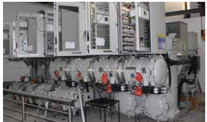
Трансформаторска станица Београд 6 сада ће бити још поузданија
